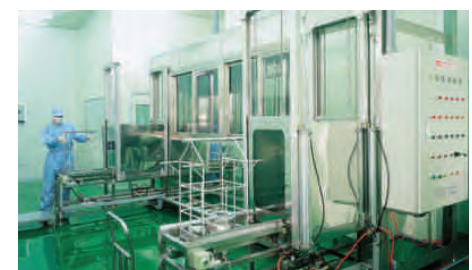
Class 10,000 無塵室 禁油洗淨設備
