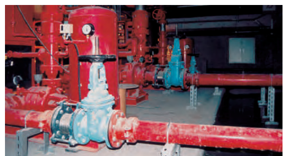
消防機房 16K閥使用實例
